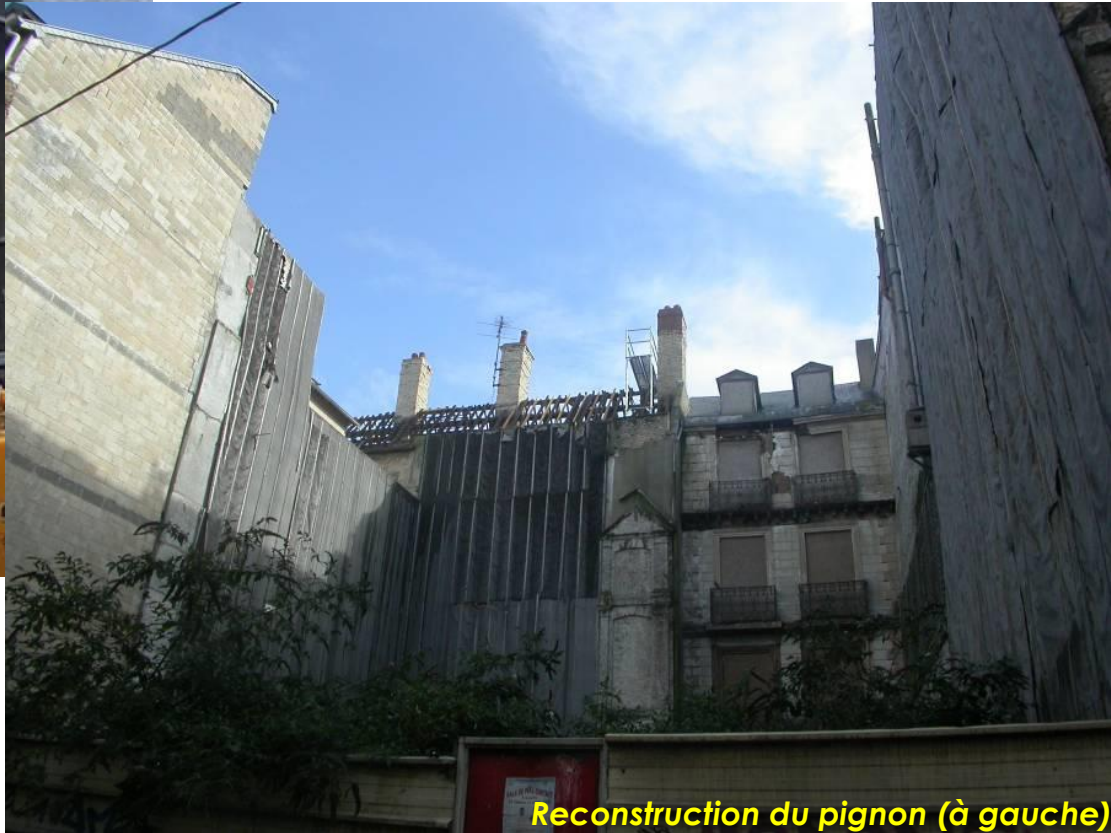
L'effondrement a emporté le mur mitoyen...
