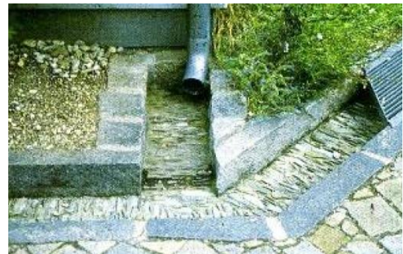
Doc 4 Gouttière visible © Urban-Eco Scop
