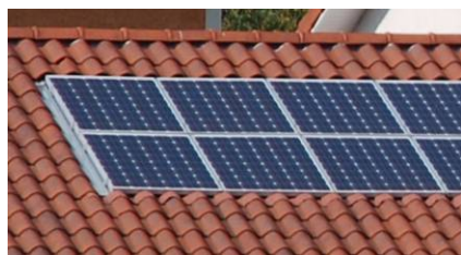
Exemple de panneaux solaires photovoltaïques
