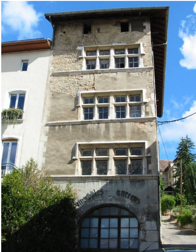
Façade en train de perdre son enduit protecteur...
