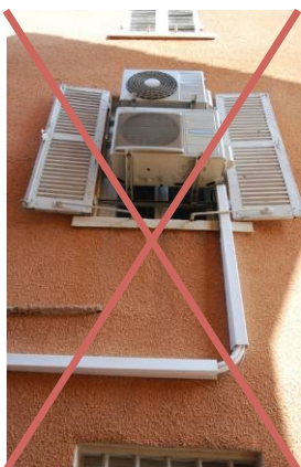
Appareillage de climatisation rapporté
