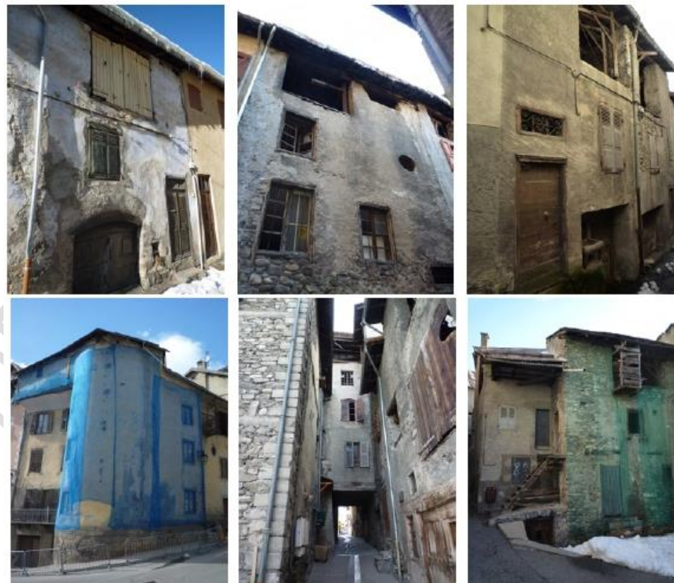
Exemples d'immeubles profondément dégradés du centre-bourg et/ou inoccupés depuis de longues années.
